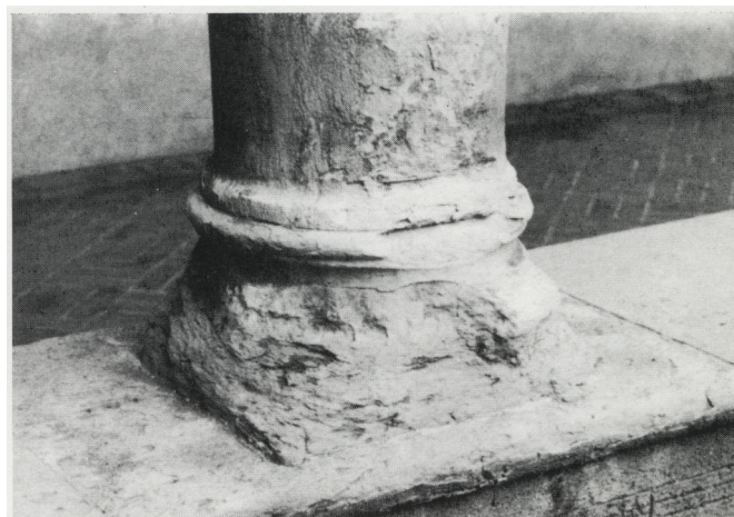
Fig. 2 - Fenomeni di erosione e fessurazione con formazione di scaglie.
