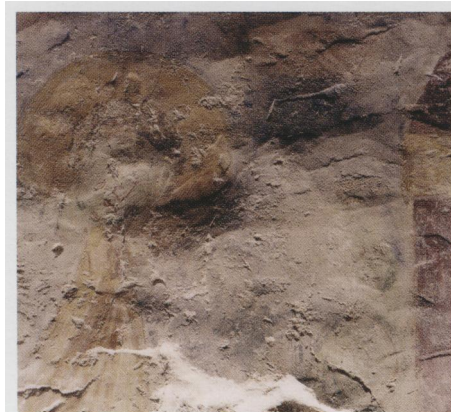
A. Foto a luce radente che evidenzia la stesura irregolare degli intonaci.
